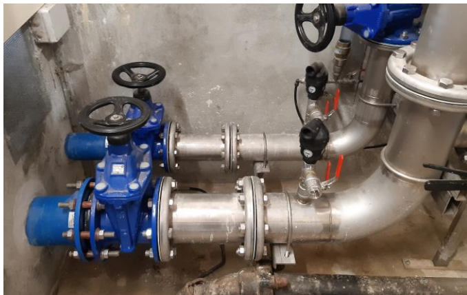
Réservoir de la Bonasse Départ du secours vers Orgemont et la Chaume + arrivée du pompage des Echelles
