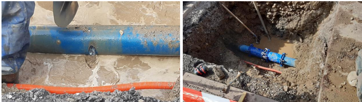
Fuite à Lovagny et sa réparation
