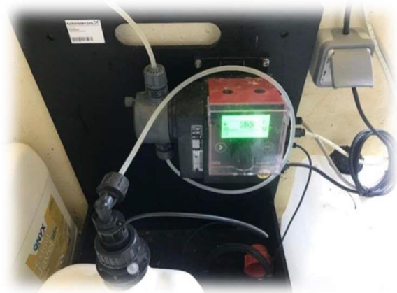
Pompe doseuse de chlore
