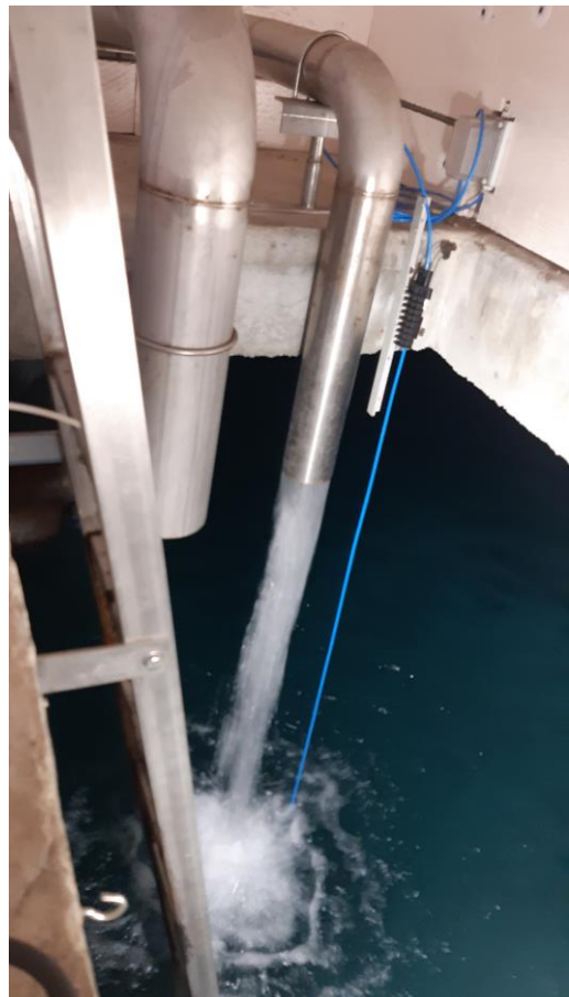
Réservoir de la Bonasse Arrivée du pompage des Echelles
