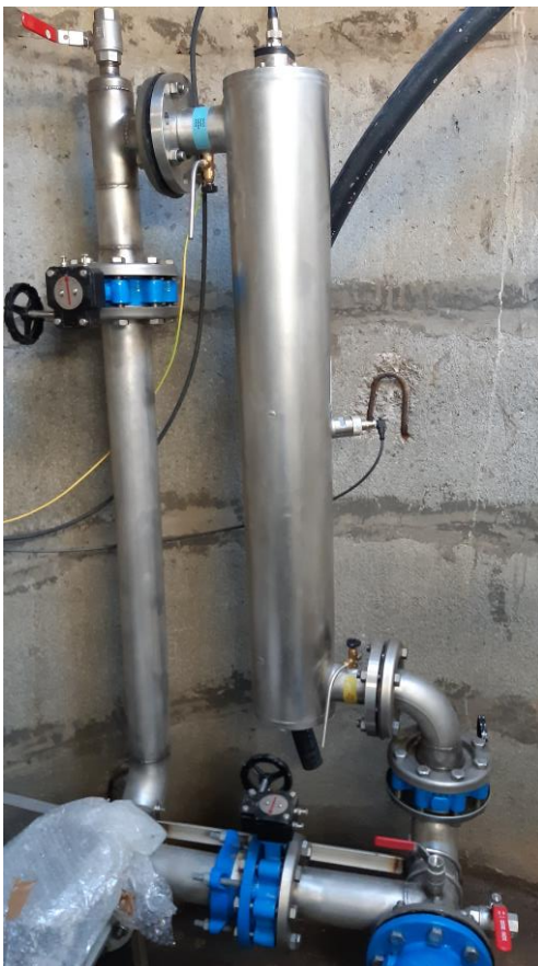
Station de pompage du Lac Nouvel UV après rénovation
